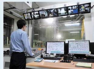
▲ 產線出口全自動電腦控制監控系統 Auto-PC Monitoring System
